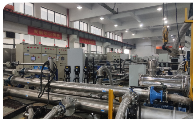
出厂检测中心
