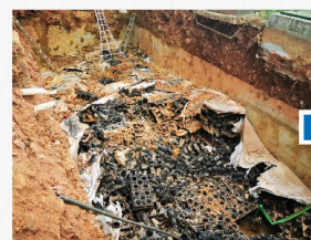
模块水池坍塌
